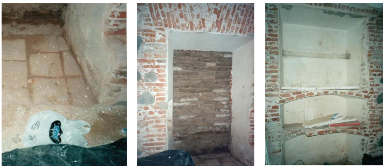
F. 4, 5 y 6. Ex rectorado de la UNC en proceso de reformas. Solados y revoques originales. Puertas y nichos sellados, 2000.
